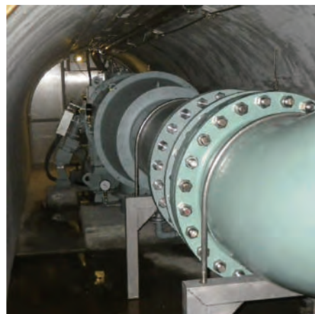
初瀬水路 (小水力発電施設)
