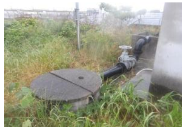
ポンプ設備全景
