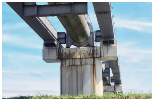
思案橋水管橋下部工のひび割れ
