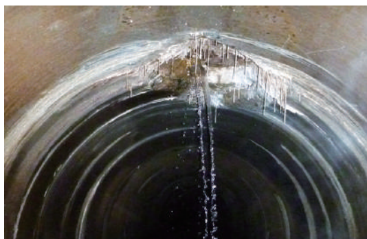
トンネル頂部の欠損
