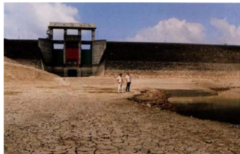
干上がった寺内ダム（平成 6 年渇水）
