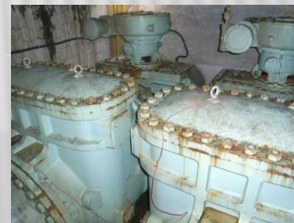
地下に設置している逆支弁
