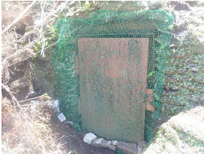
地質調査横坑(T-1横坑)の入口の閉塞状況 (平成28年5月)
