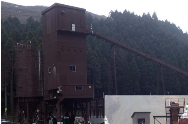
バッチャープラント
