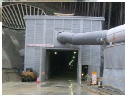
坑口部防音扉の例
