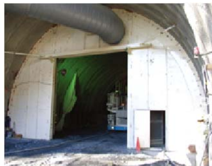
坑内防音扉の例
