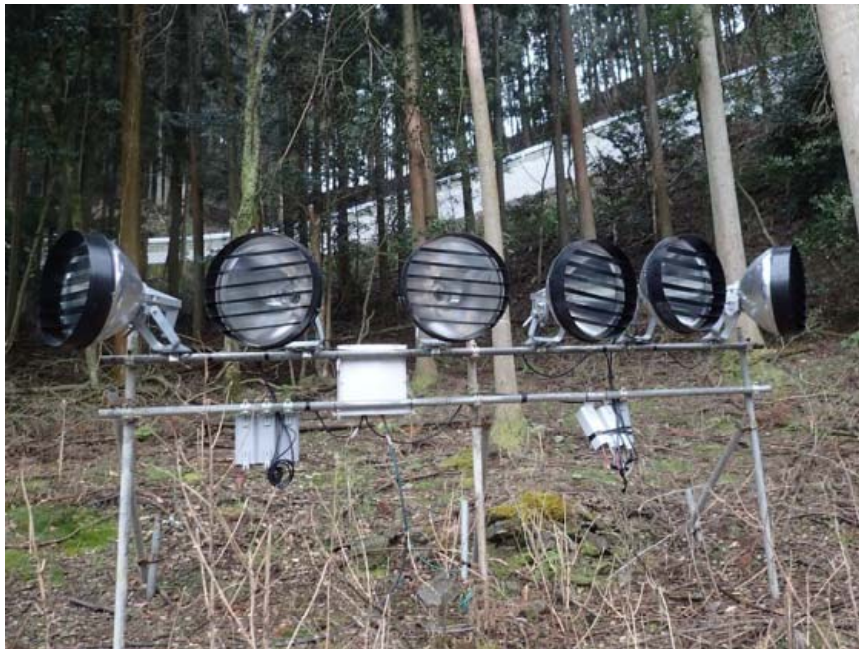
照明方向制御ルーバーを取り付けたライト
