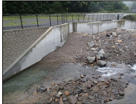
取水堰上流側土石堆積(9月)
