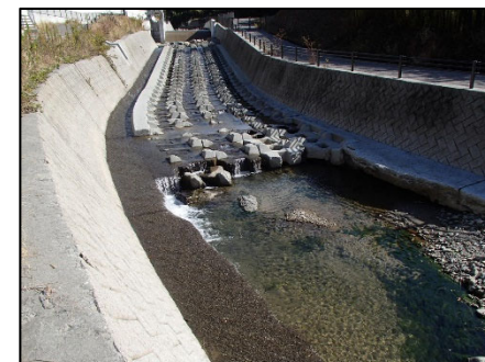
施設下流側水路・自然石区間 の自然石流出(9月)
