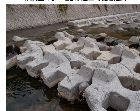
下流側水路に生じた落差(R3.11月) ※流量の少ないときは落差が大きくなり、根固ブロックは伏流する区間が生じ遡上困難と推測
