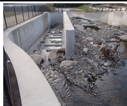
魚道の出口(R3.4月) ※湛水域、魚道出口に土砂が堆積
