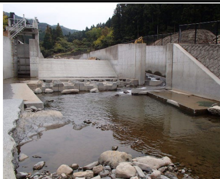
魚道の入口(R3.11月) ※8月の大雨後に堰下流が洗掘
