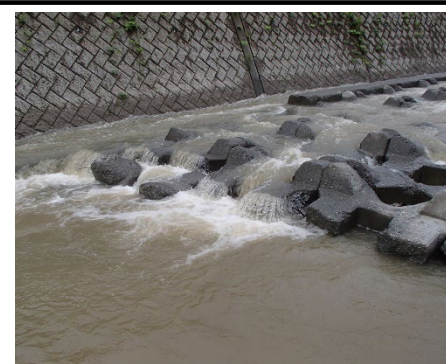
下流側水路に生じた落差(R3.5月) ※流量の多いときは遡上可能と推測
