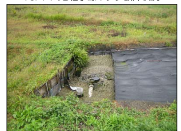
10/14のB社水源ポンプ故障状況
