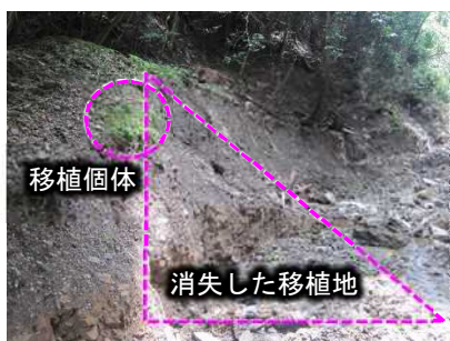
写真 4-11 九州北部豪雨の被害
