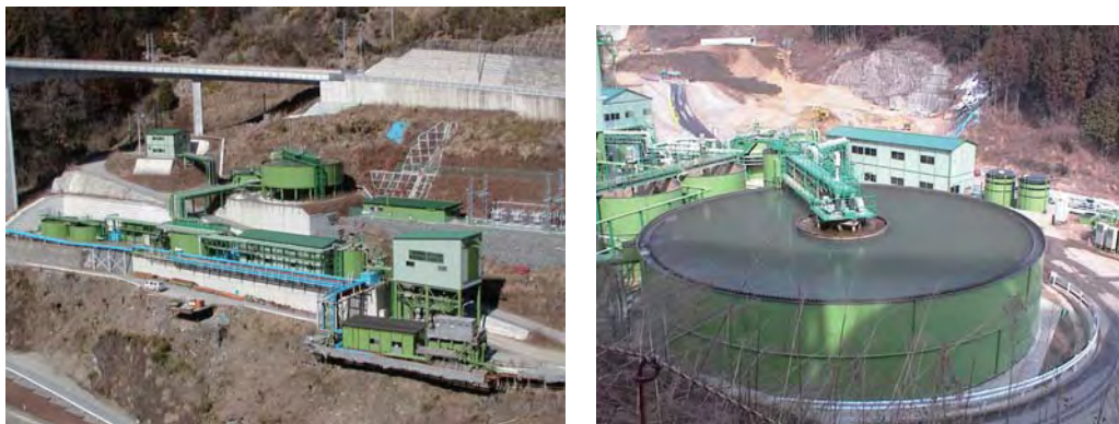
濁水処理設備 (滝沢ダムの例)
