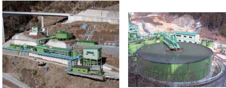
濁水処理設備（滝沢ダムの例）
