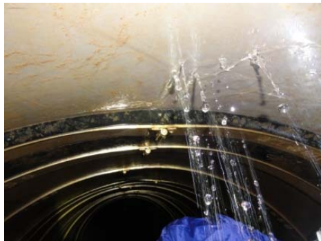
クラックからの漏水
