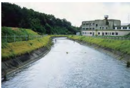
改修前の幹線水路
