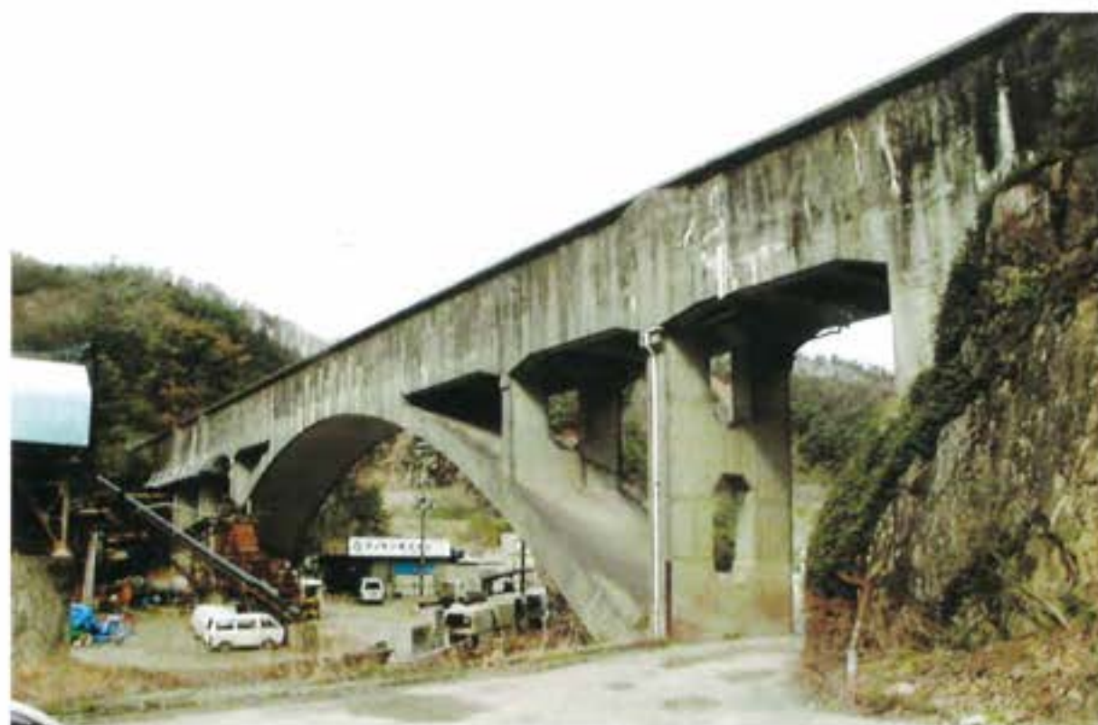
漏水対策を施しながら水を流し続けた水路橋
