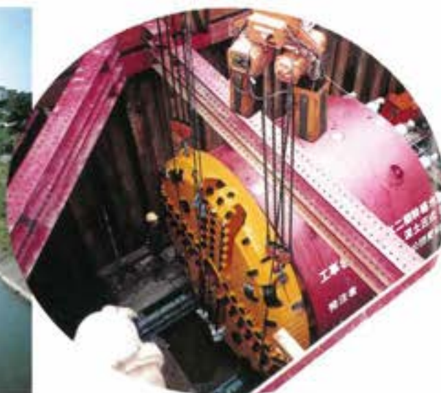
泥土加圧式シールド掘進機
