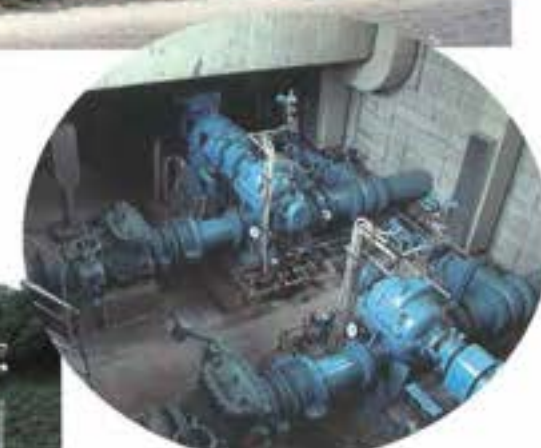
更新したポンプ
