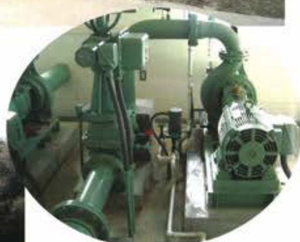
更新したポンプ
