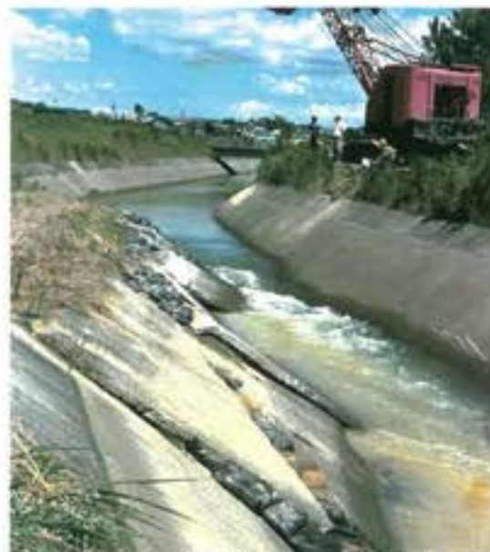
台風による被害（東郷第4開水路…東郷町）
