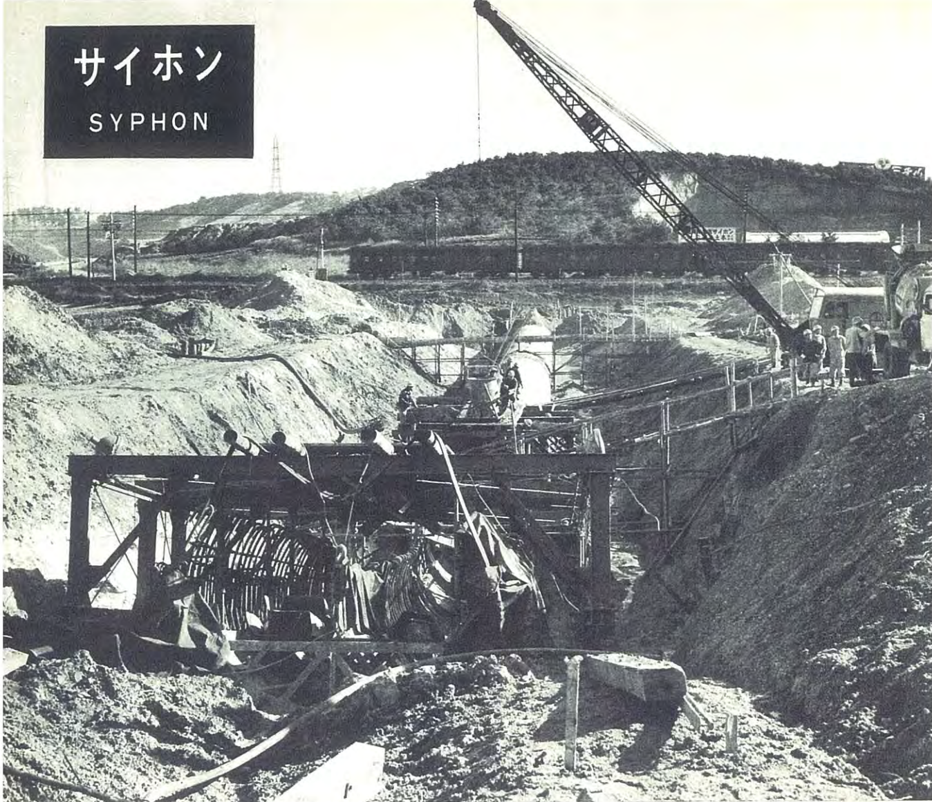
■ 下流部からみた大高サイホン、向う通るは東海道本線の列車
