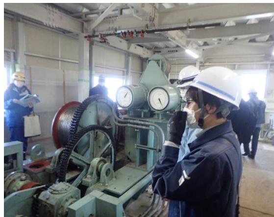
■ 開閉装置室内の見学
