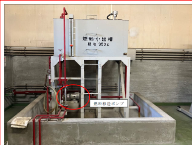
図 2-3-3 燃料移送ポンプ
