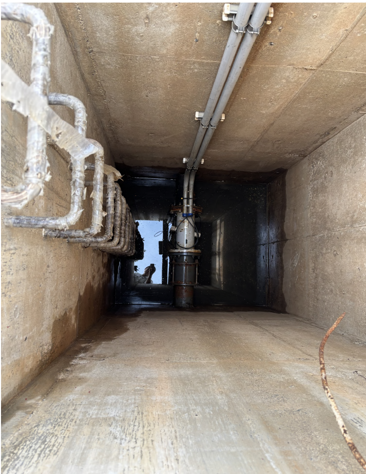
流量計室内状況
