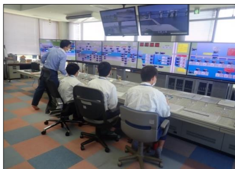
総管操作室:概要説明②
