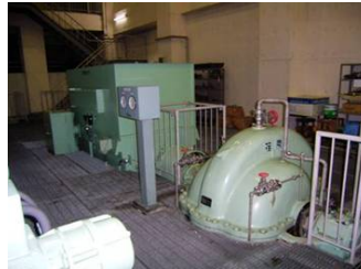
都市用水1号ポンプ
