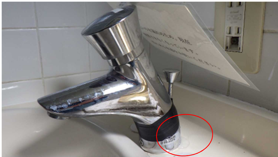
水栓から水を出すと水が漏れる
