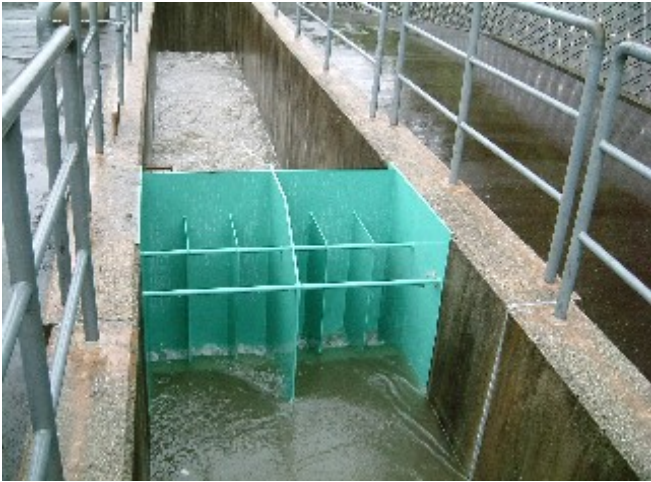
ディストリビューター～量水堰(刃形堰) 写真最奥部は導水トンネルまたは幹線水路合流部へ
