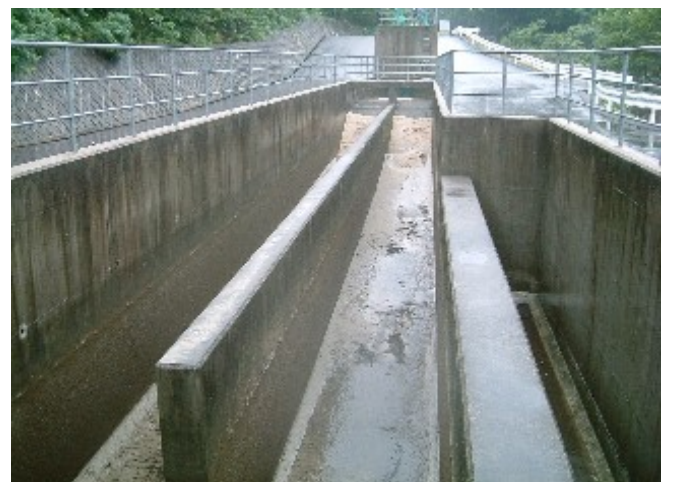
沈砂池(空水時)
