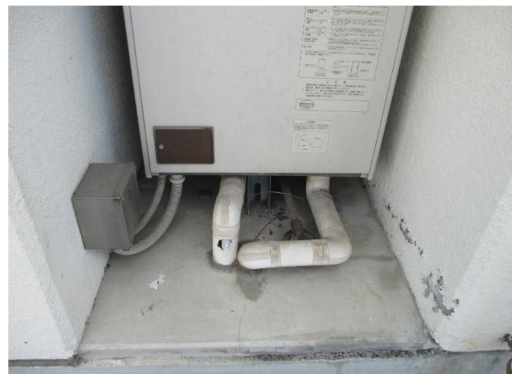
既設電気温水器配管等状況
