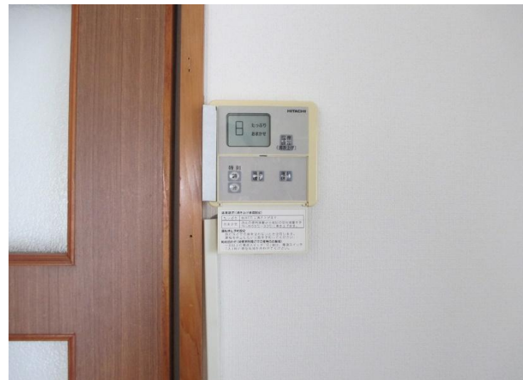
既設給湯専用リモコン
