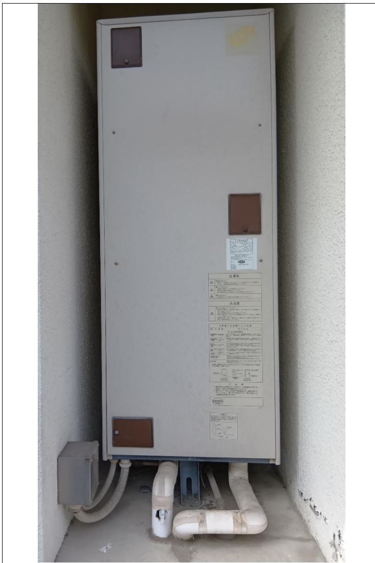
既設電気温水器
