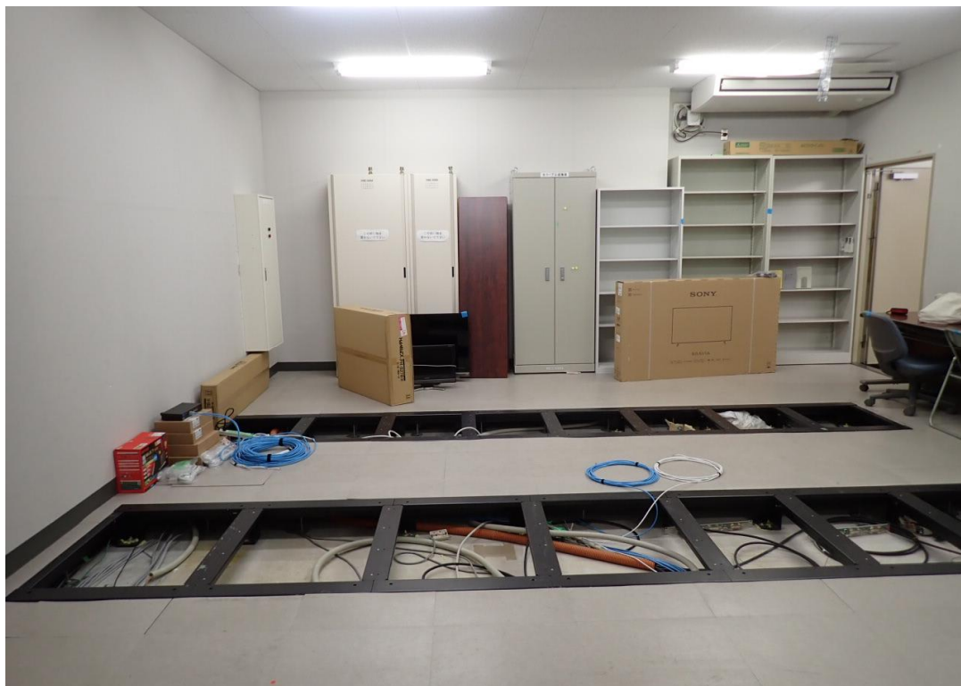
サーバー室の状況
