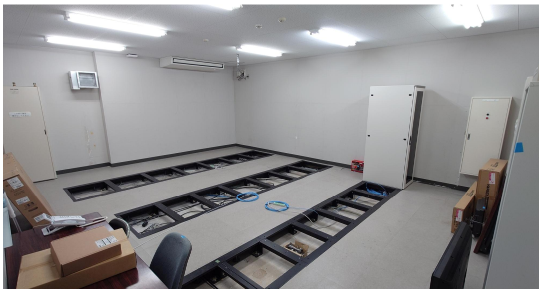
サーバー室の状況
