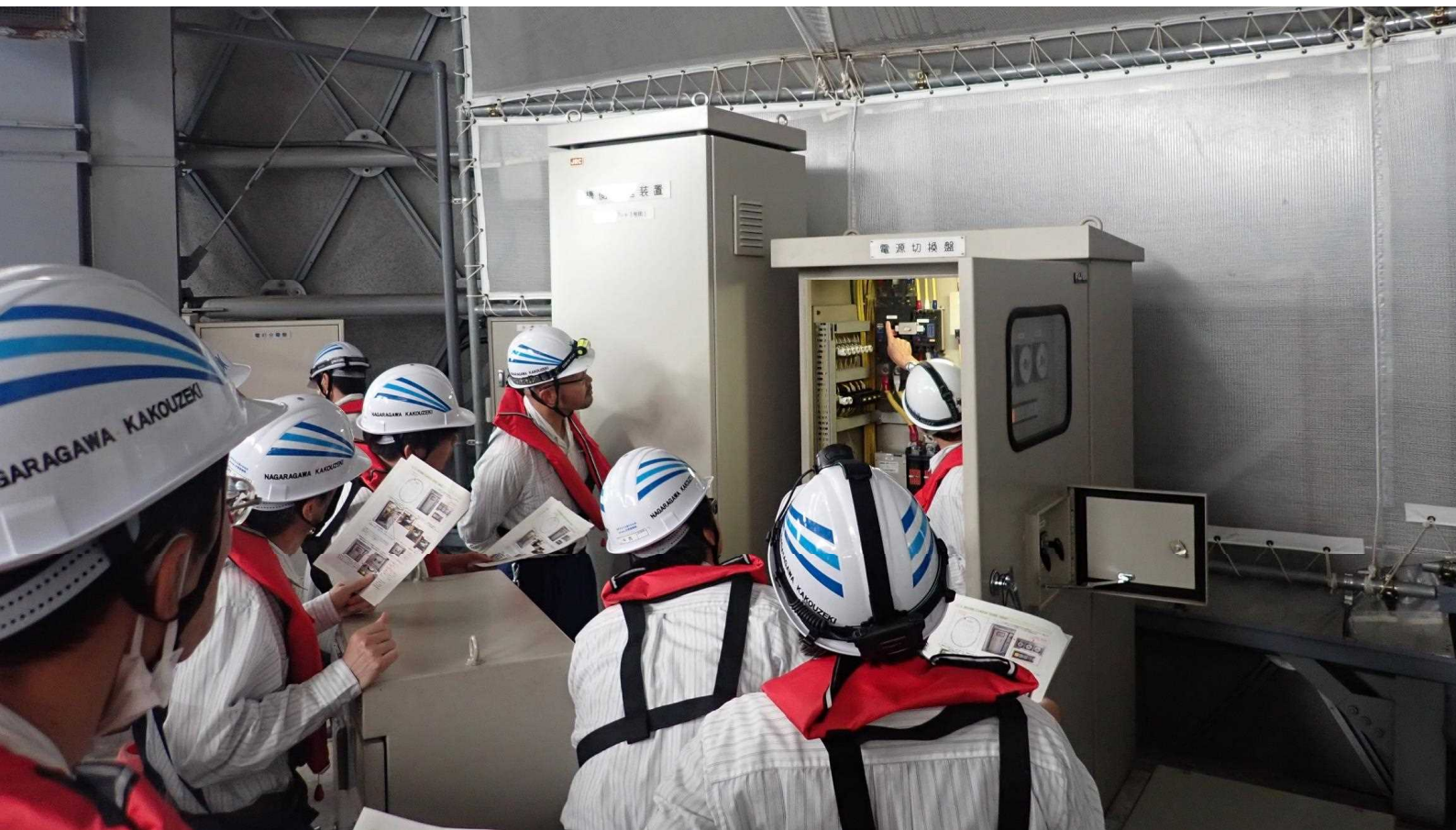
予備発電設備操作訓練(ゲート巻き上げ機室)
