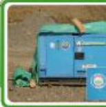
低騒音型発電機
