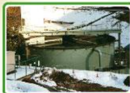
濁水処理施設
