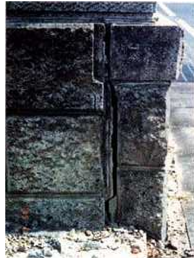
平成7年8月 壁の亀裂
