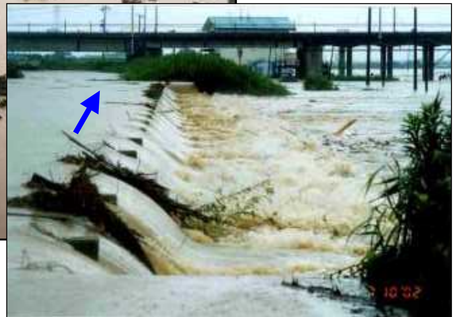
大谷川の洗堰からの越水状況(大垣市) 11 -
