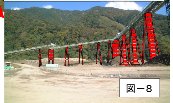
ベルトコンベア支柱の残置
