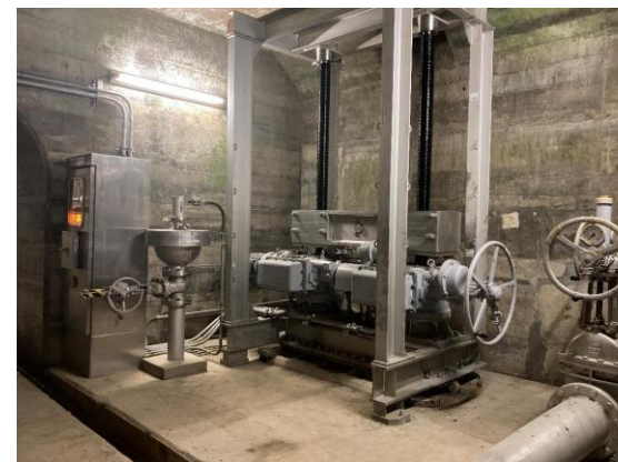
制水ゲート開閉装置
