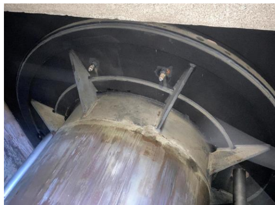
取水バルブ(コーン側隔壁)
