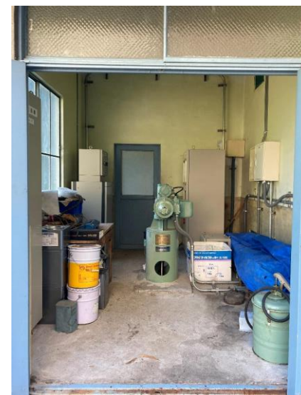
開閉装置及び操作制御設備
