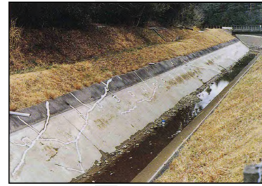
開水路のひびわれ
