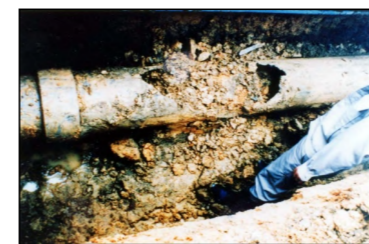
石綿管破損状況
