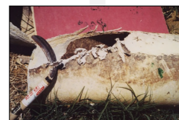
鎌で切断できる老朽化した石綿管
