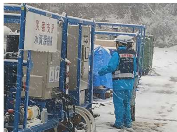
装置の稼働状況を確認
