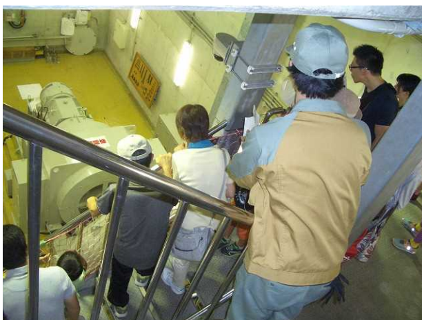
比奈知発電所
