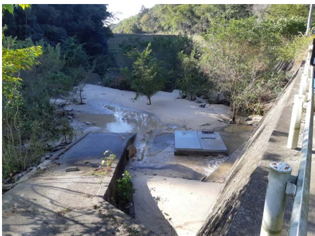
漏水発生箇所①(遠景)
