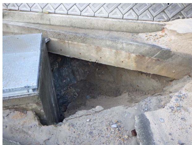
漏水発生箇所②(近景)
