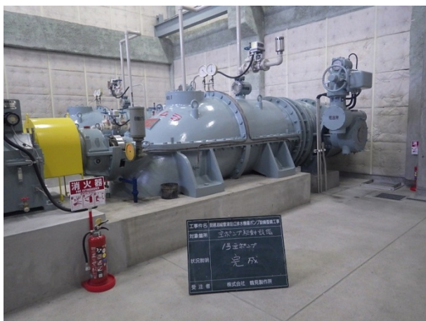
排水ポンプ写真
