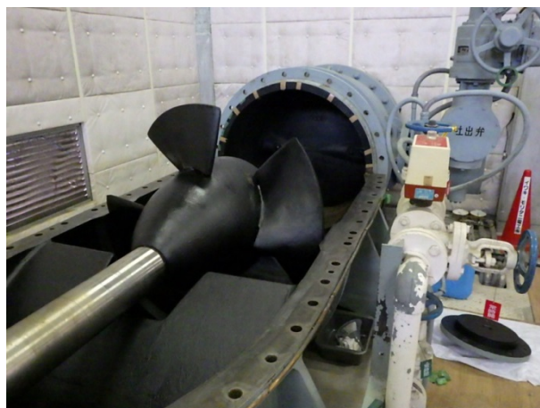
排水ポンプ開放状態写真
