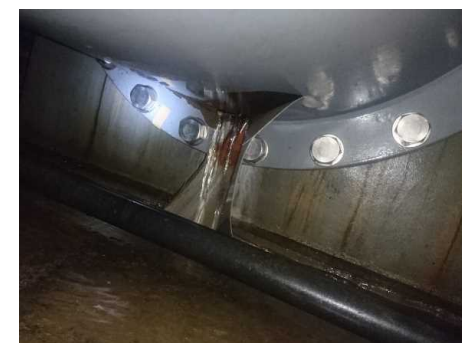
管路欠損状況
