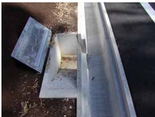
写真-5 小動物に優しい側溝
