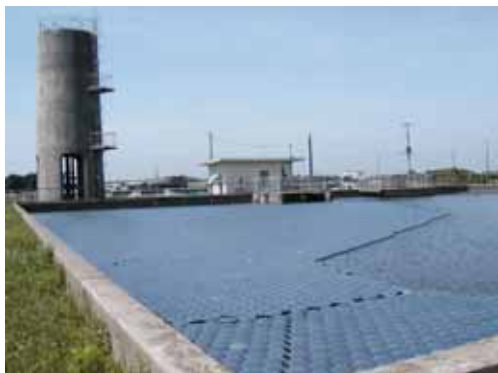
写真-3 F.Pに設置された六角フロート
