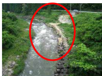
土砂掃流後の状況
