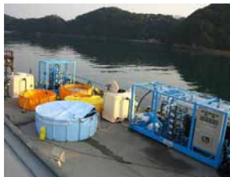
写真－３ 装置配置状況
