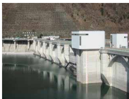
写真 - 3 濁水長期防止を目的とした清水バイパス（浦山ダム）
