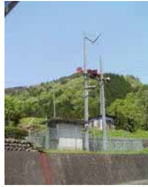
写真 - 2 警報設備
