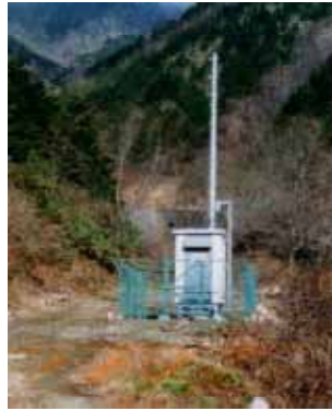
写真 - 1 雨量観測設備
