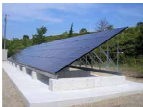
写真 - 4 陸上設置の太陽光発電設備
