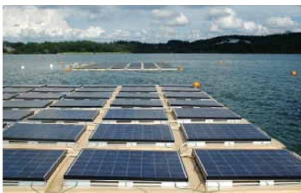
写真 - 2 水面設置の太陽光発電設備
