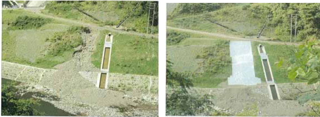
写真－２ 徳山ダム貯水池斜面被災状況及び補修状況
