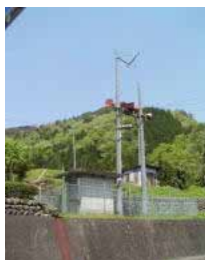
写真－２ 警報設備
