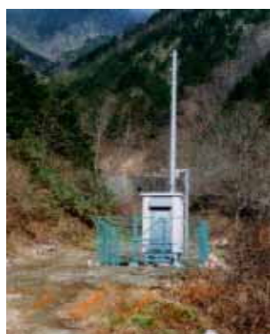
写真－１ 雨量観測設備
