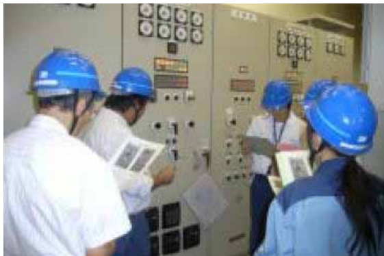
写真-3 予備発電設備操作訓練状況
