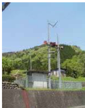
写真－２ 警報設備
