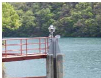
写真－９ 監視カメラ（香川用水）
