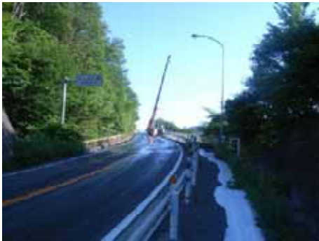
写真－３ 薬品流出状況
