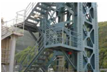
写真-3 右岸監視カメラ
