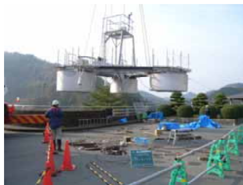
写真－3 浅層曝気循環設備 （室生ダム）
