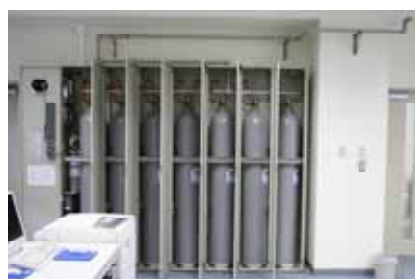
写真-2 自動消火設備
