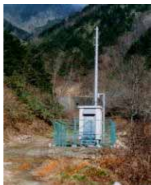
写真－１ 雨量観測設備
