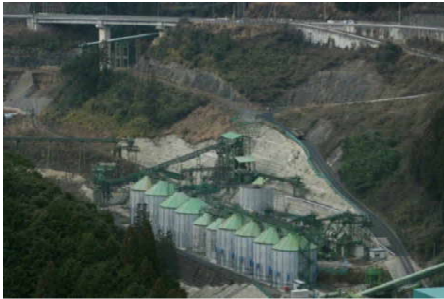
写真－３ 骨材製造設備（大山ダム）
