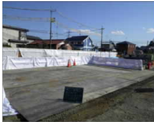
写真－１２ 作業構台の漏油防止対策
