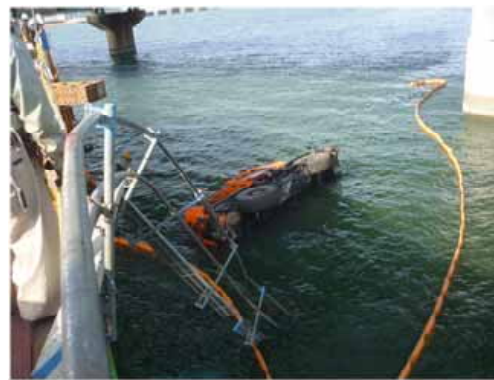
写真-14 クレーン転落状況
