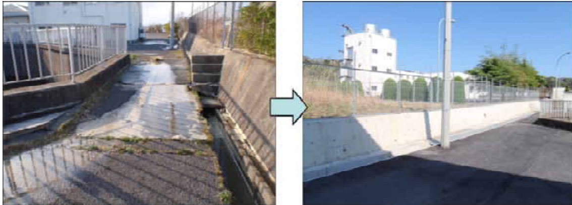
写真－４ 災害復旧の状況（東庄揚水機場の沈下した擁壁、防護柵及び場内舗装の原型復旧） 〔東総用水施設〕
