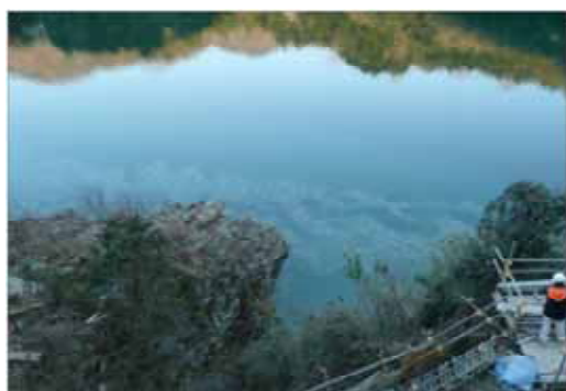
写真－３ エアモルタル流出状況
