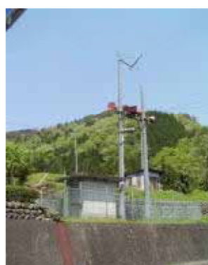
写真－２ 警報設備
