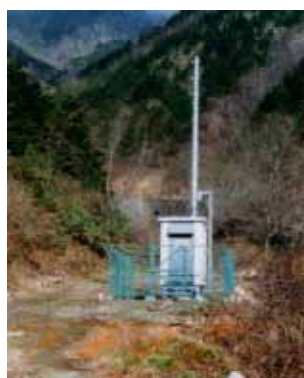
写真－１ 雨量観測設備
