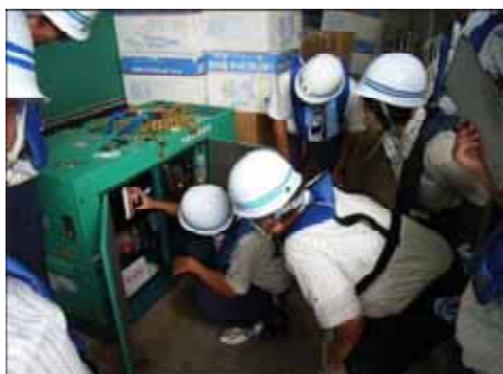
写真-5 予備発電設備操作訓練状況
