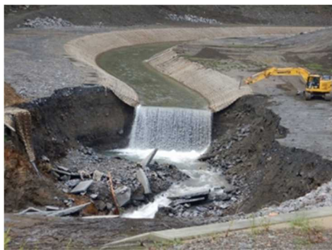
(河床水路の流出状況)
