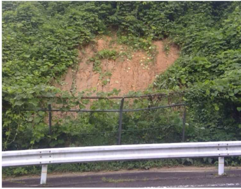
(法面崩落状況)
