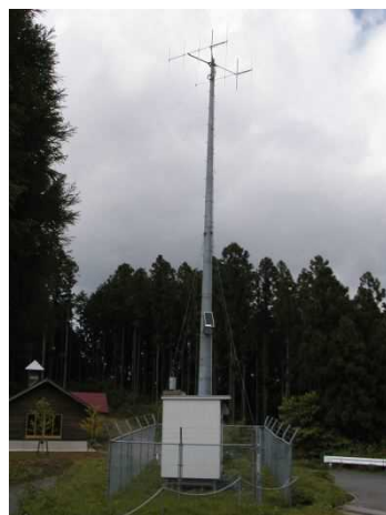
写真－1 雨量観測設備
