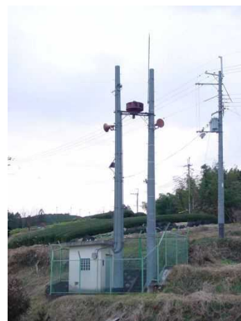
写真－2 警報設備
