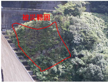
(法面崩落状況)
