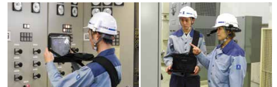
タブレット・HMDを活用した設備操作支援 (琵琶湖開発総合管理所)
