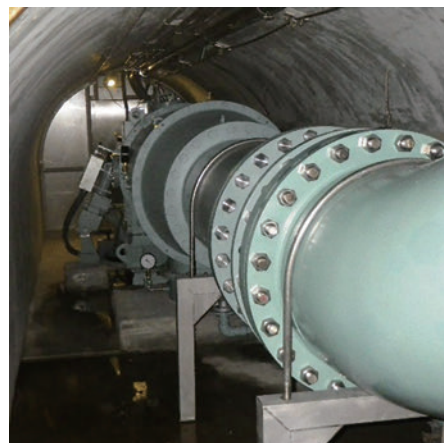
初瀬水路 (小水力発電施設)
